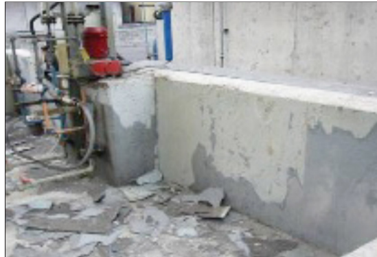
Recubrimiento dañado después de derrames.
